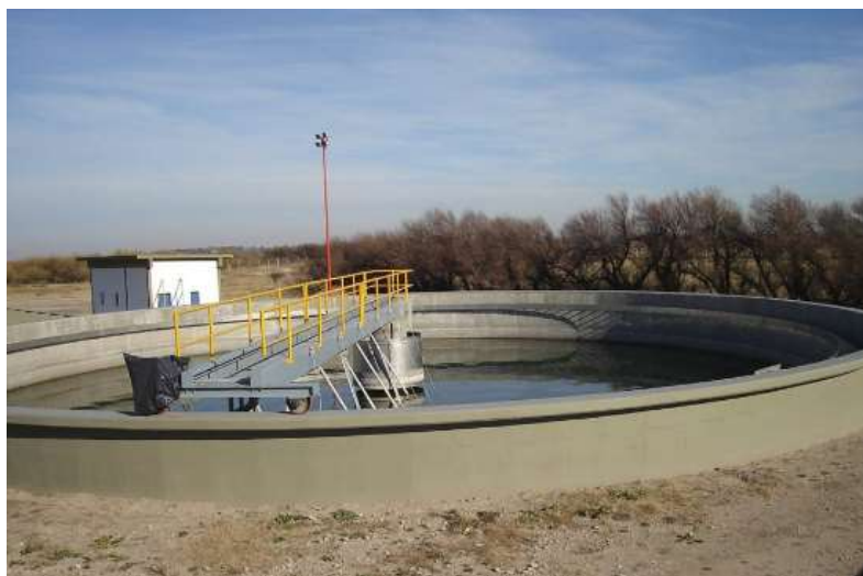
Figura 57. Reactor aeróbico con aireación. Fuente: www.site.panedile.com .
