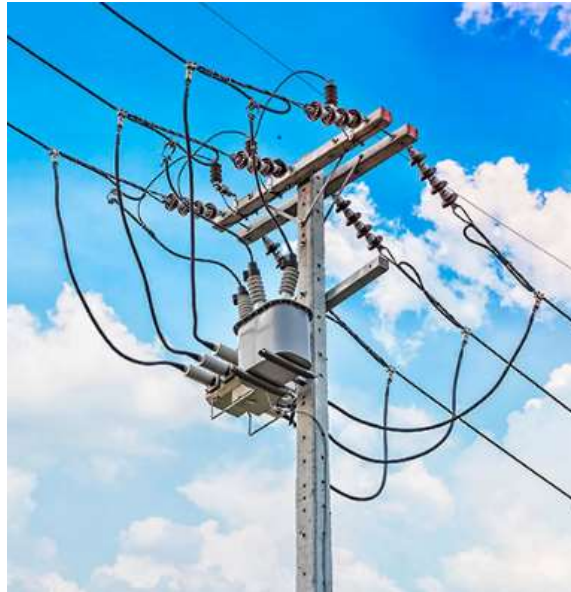
Figura 65. Red de distribución área. Fuente: EDES.
