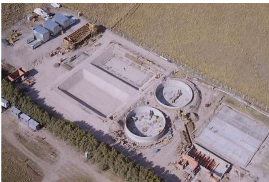
Figura 56. Planta Depuradora Tercer Cuenca. Fuente: www.site.panedile.com .
