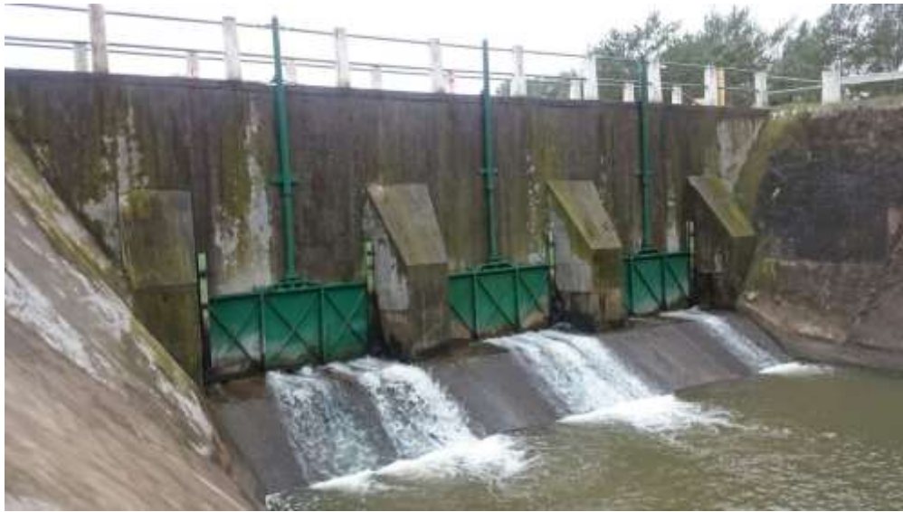
Figura 122. Compuertas de regulación del Arroyo Napostá. Fuente: Elaboración propia.
