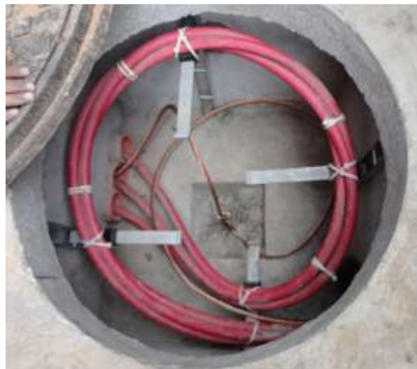
Figura 66. Red de distribución subterránea. Fuente: EDES.
